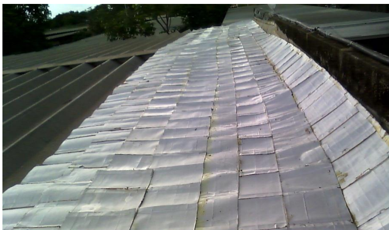
Figura 3.8 – PIT instalado sobre o telhado da sala de Física.
